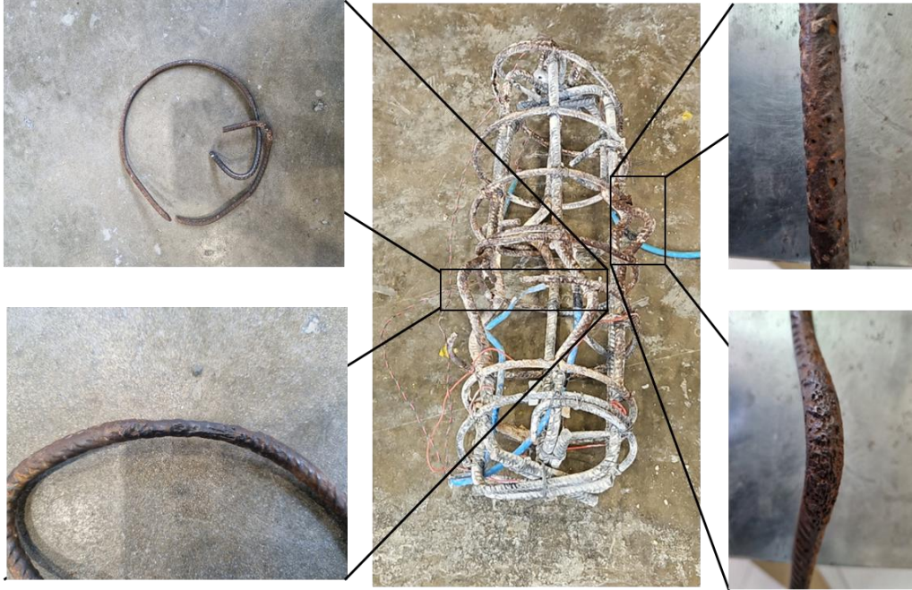
Figure 15: Photograph of the rebars removed from SCS sample איור 15 : תצלום של המוטות שהוסרו מדגימת SCS
