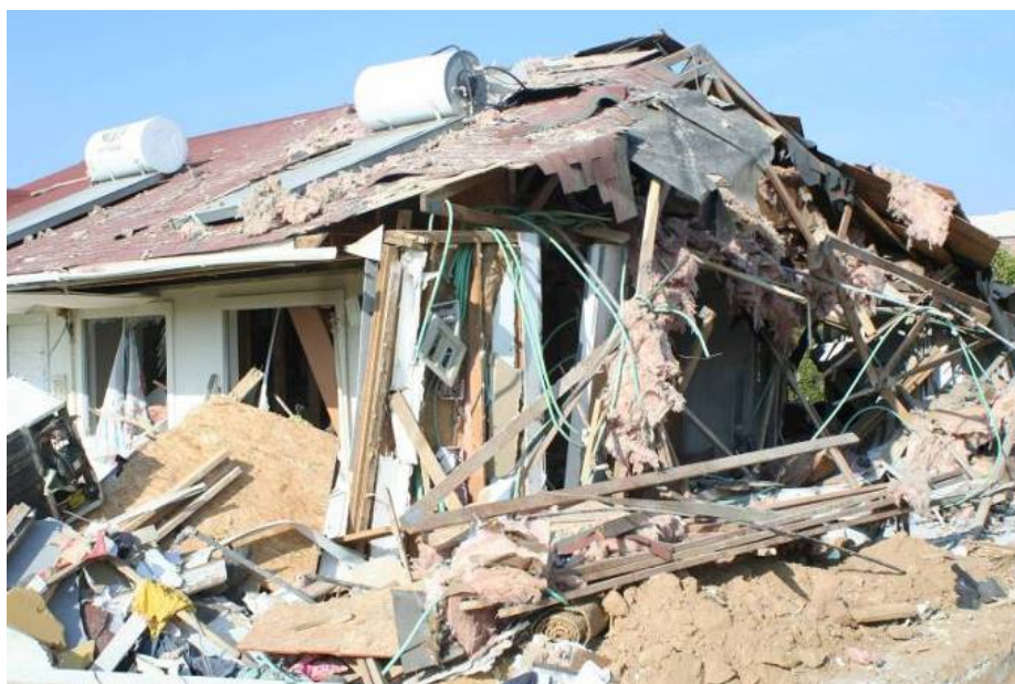
איור 4.10: הרס כללי של חלק מבניין מגורים שנבנה בשיטת "בנייה קלה" כתוצאה מפגיעה ישירה של רקטת 122 מ"מ בגג הבניין
