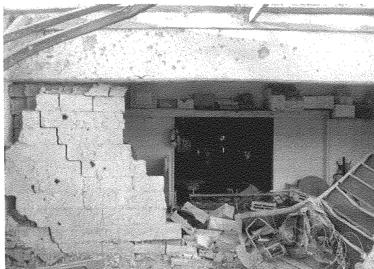
איור 4.17: הרס מקומי של קיר בני הבנוי מבלוקי בטון מאושפרים באוטוקלב (איטונג) כתוצאה מפגיעה קרובה של רקטה בקוטר 122 מ"מ בקרבתו
