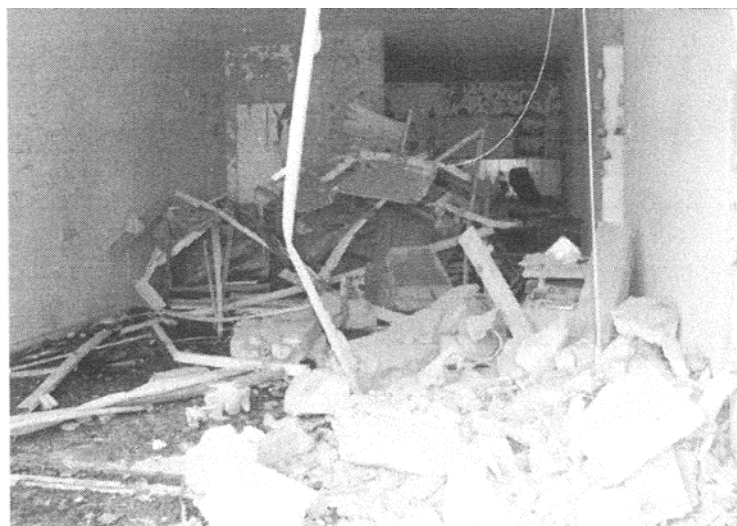
איור 4.21: הרס מקומי בתוך דירה בקומת קרקע של בניין מגורים המוצג באיור 4.20, כתוצאה מפגיעה קרובה של רקטה בקוטר 220 מ"מ מחוץ לבניין
