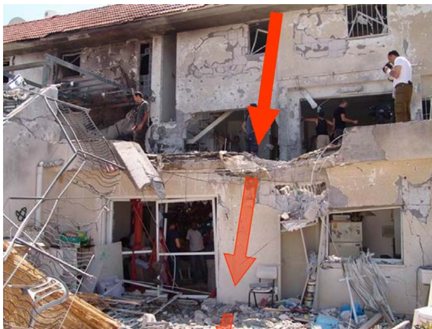
איור 4.12: נזק נרחב שנגרם לבניין מגורים מדורג הבנוי בשיטות בנייה קונוונציונליות כתוצאה מפגיעה ישירה של רקטת 220 מ"מ במרפסת גג הבניין
