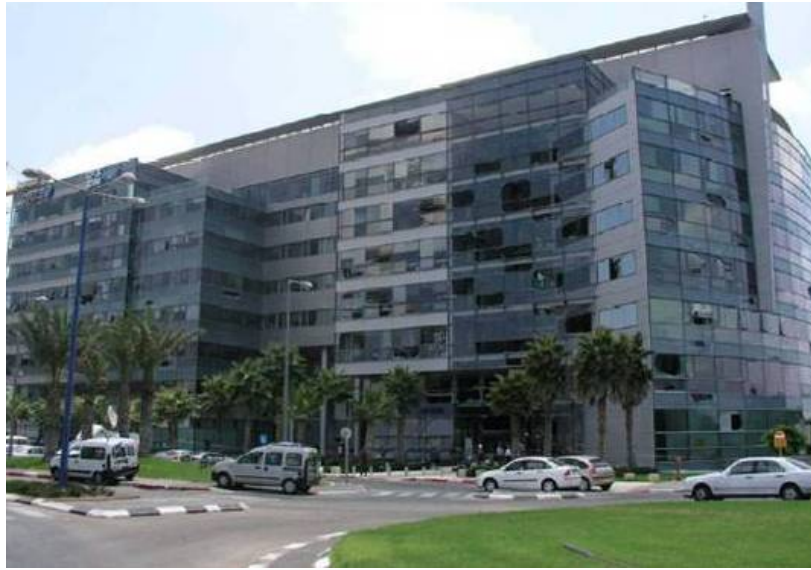
איור 4.32: ניפוח של חלק מחלונות בניין משרדים כתוצאה מפיצוץ רקטה בקוטר 302 מ"מ בקרבת הבניין
