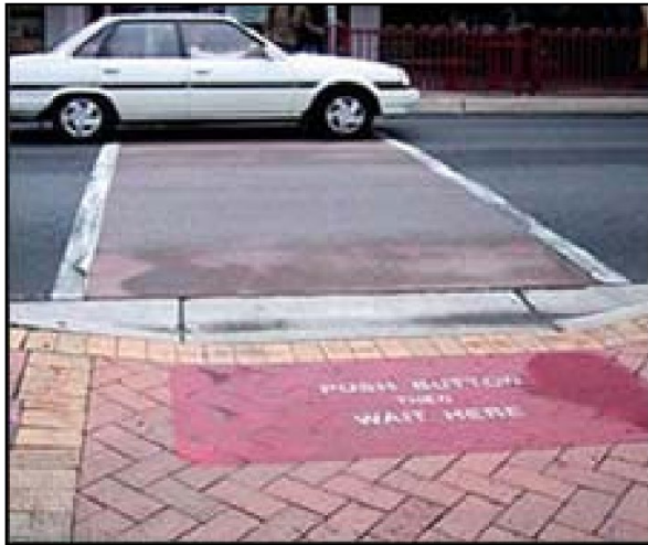
משטח דריכה לפני מעבר חצייה באוסטרליה (מקור: Steindel 13 )
