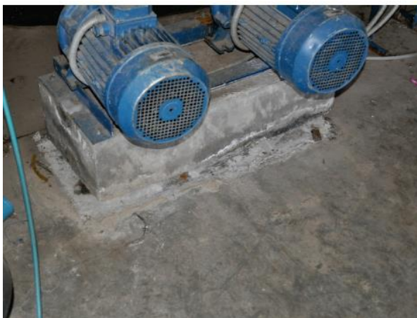
איור 6.4.1.1-2 - כשל בבסיס אליו עוגנו המשאבות.
