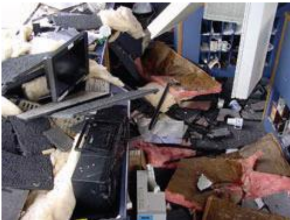
איור 6.5.3.3-2 – נזק בחדר בקרה בשדה תעופה
