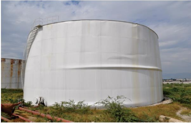
איור 6.4.2.2-3 - כשל בדופן מיכל.
