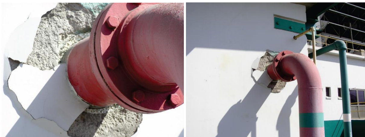
איור 6.4.3.8-2 – נזק שנגרם לטיח סטוקו חיצוני באזור חדירת צנרת כיבוי אש.
