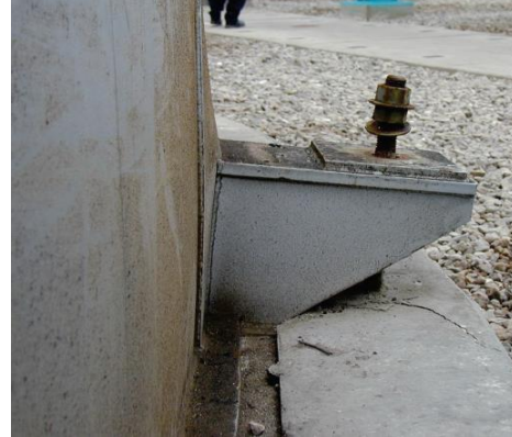
איור 6.4.2.2-1 - כשל בחיבורי בסיס של מיכל דלק (5000 מ"ק).
