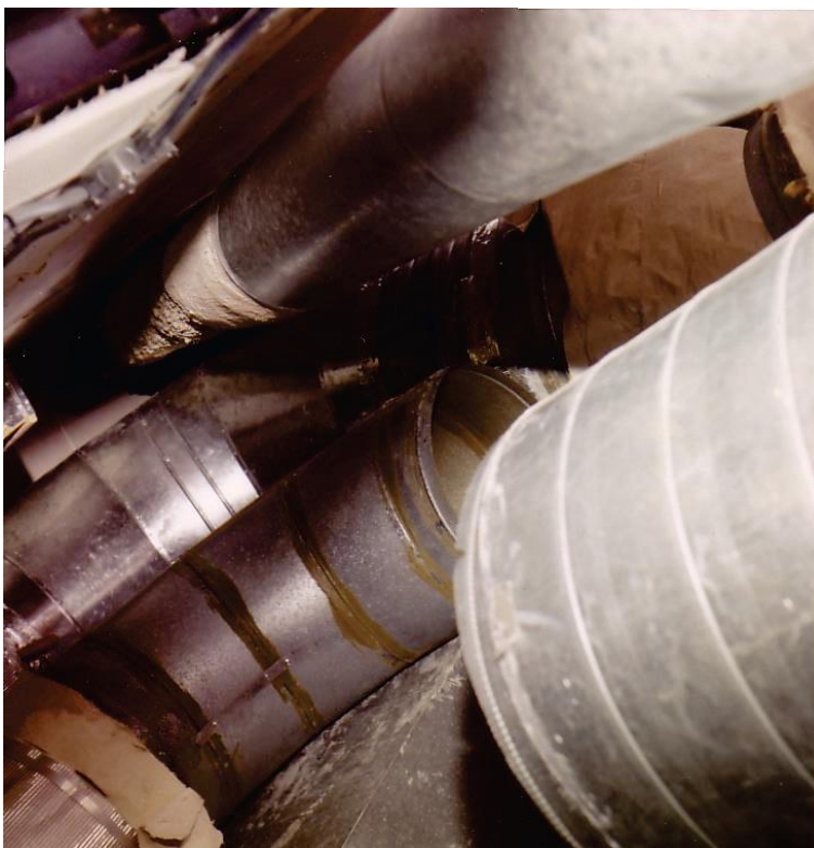
איור 6.4.6.1-1 – תעלה לא מעוגנת שהתפרקה לחלקים.
