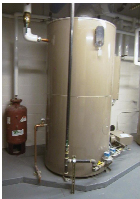
איור 6.4.2.4-5 – דוד מים בבית ספר מעוגן בבסיסו.
