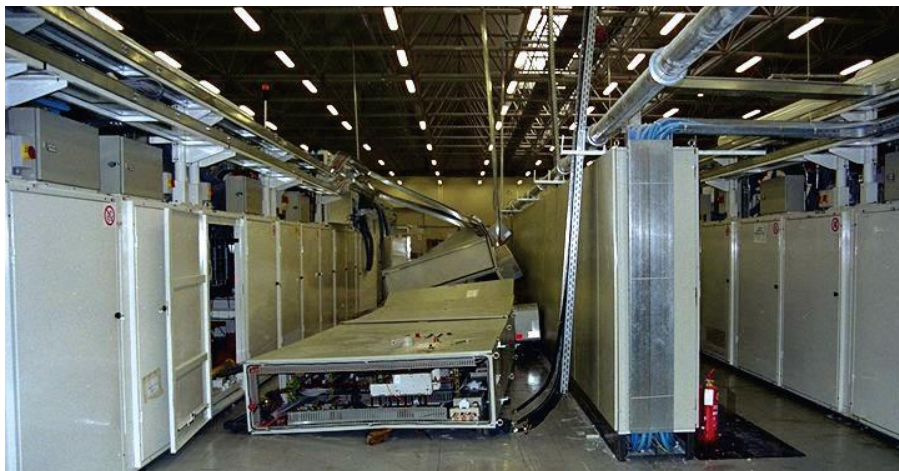
איור 6.4.7.1-2 – התהפכות ארונות חשמל לא מעוגנים במפעל לייצור נייר.
