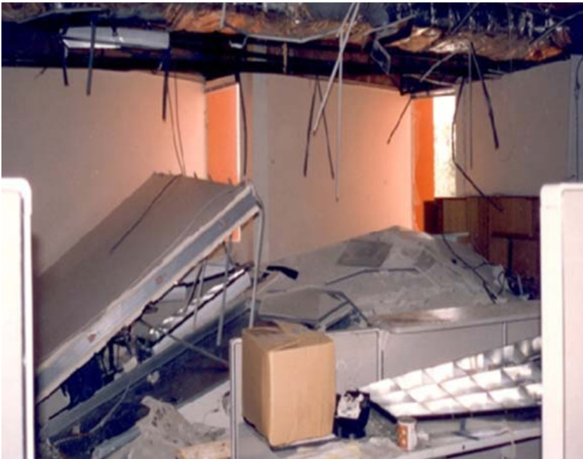
תרשים ט-2: התמוטטות תקרת תותב ברעידת האדמה ב-Northridge ארה"ב (1994)
