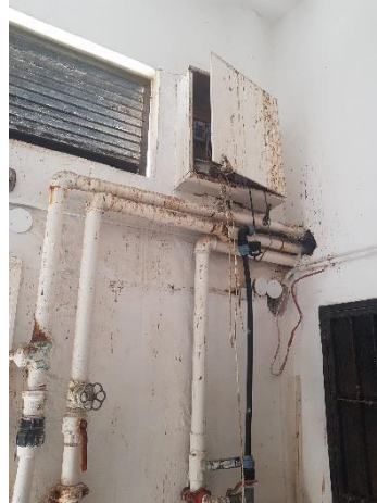
תחזוקה לקויה, ארון חשמל לא בשימוש
