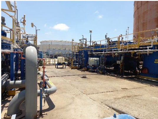
מתקן ה-DGF לאחר ניקוי (12/7/22)
