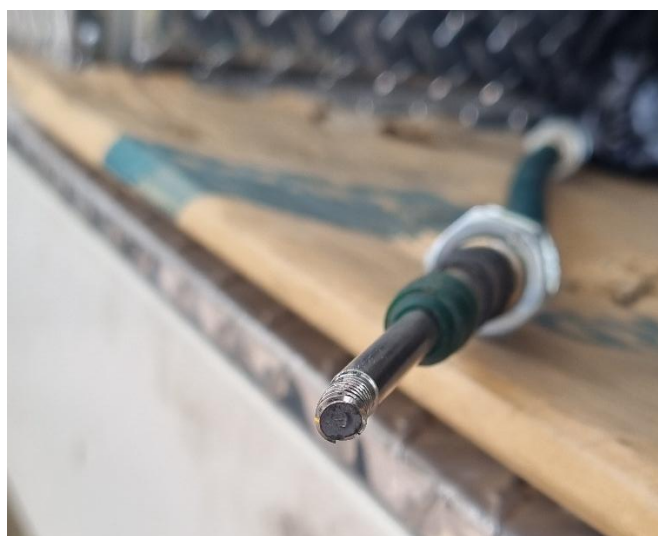
תמונה 10 - כבל טרפלקס חיבור שבור (בחיבור למזלג)
